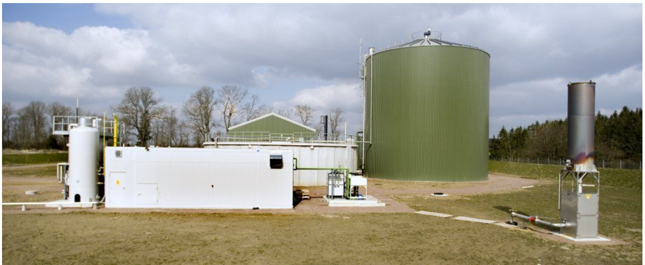
Bild 6: Uppgraderingsanläggning med PSA-teknik (den vita byggnaden i förgrunden) på biogasanläggningen utanför Bjuv. (Bild: Mattias Hennius, E.ON Gas AB)
